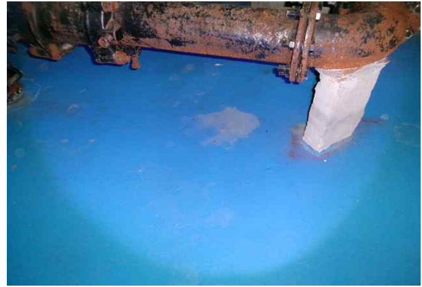
손상내용 유입밸브실 바닥슬래브 도장손상 손상원인 공용중 열화
