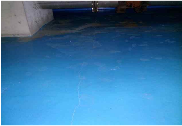
손상내용 유입밸브실 바닥슬래브 균열 손상원인 건조수축, 온도변화
