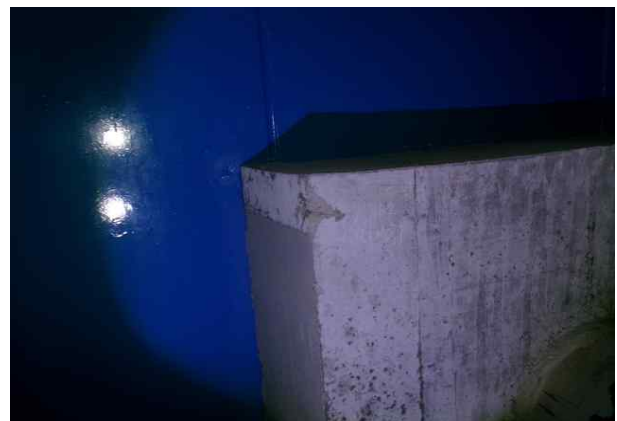
손상내용 유입밸브실 벽체 파손 손상원인 외부충격
