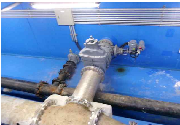
손상내용 유출밸브실 벽체 누유 손상원인 결합불량
