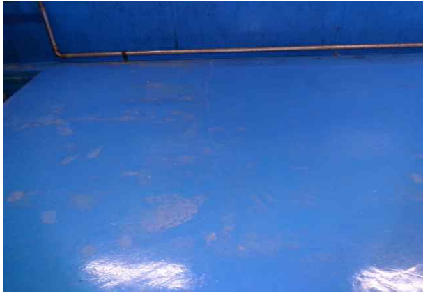
손상내용 유출밸브실 바닥슬래브 균열 손상원인 건조수축, 온도변화
