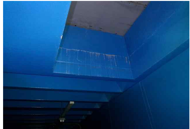
손상내용 유입밸브실 상부슬래브 백태 손상원인 외부 우수유입
