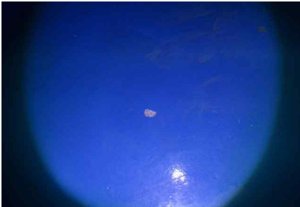
손상내용 유입밸브실 바닥슬래브 파손 손상원인 외부충격
