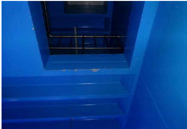
손상내용 유출밸브실 상부슬래브 파손 손상원인 외부 충격
