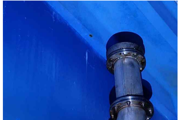
손상내용 1지 벽체 백태
