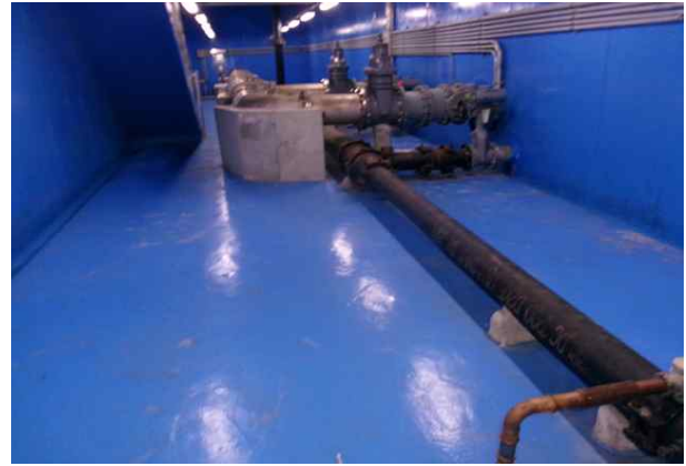
손상내용 유출밸브실 바닥슬래브 망상균열 손상원인 건조수축, 온도변화
