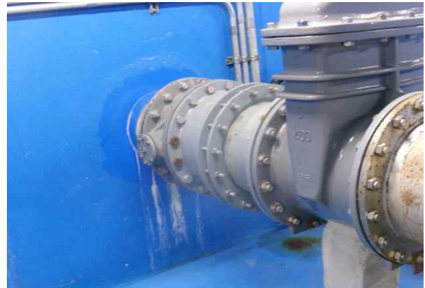
손상내용 유출밸브실 벽체 백태 손상원인 외부 우수유입
